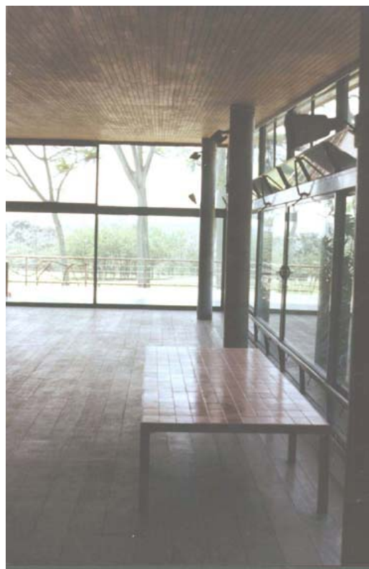
Figure 5 – Residência Olivo Gomes, São José dos Campos. Rino Levi, 1951. A estrutura independente, suporte físico e compositivo da arquitetura moderna, aparece como uma representação da modernidade em alguns compartimentos da residência.
